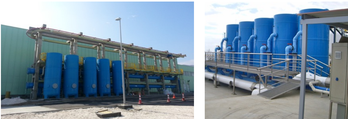
Fig. 1.2: Algunos aspectos de las diferentes instalaciones de remineralización DrinTec™.
