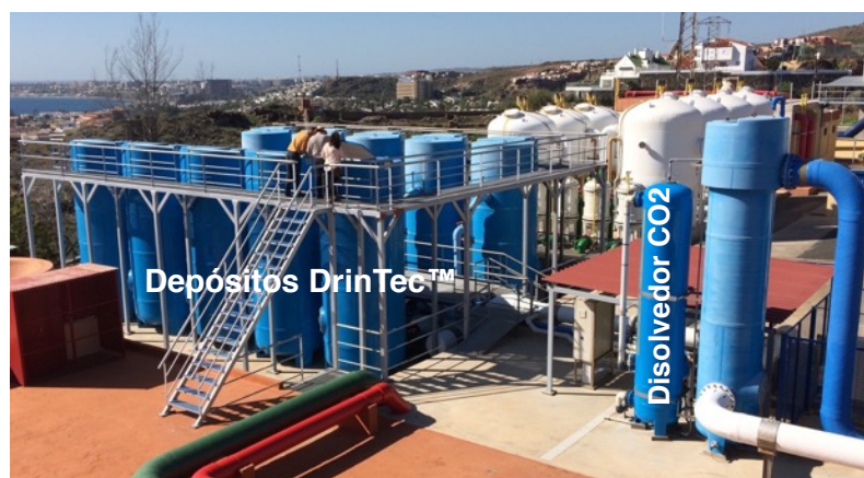
Fig. 1.3: Visión general de una instalación de diez lechos de calcita DrinTec™ con disolver de CO 2 a baja presión
